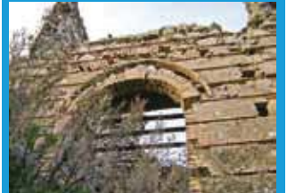
Apertura ad arco a tutto sesto e modanature sovrastanti con arco ogivale entrambi in laterizio
